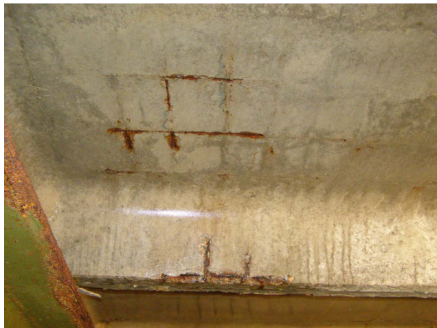
2.15 pav. Plokščių lentynų darbo armatūros korozija
