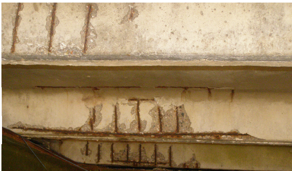
2.8 pav. Denginio plokščių išilginių briaunų skersinės armatūros pažeidimai
