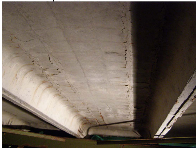
2.14 pav. Plokščių lentynų paskirstomosios armatūros korozija
