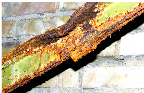
2.17 pav. Deformuotas korozijos pažeistas santvaros pastato ašyje 11 tinklelio elementas T-9.
