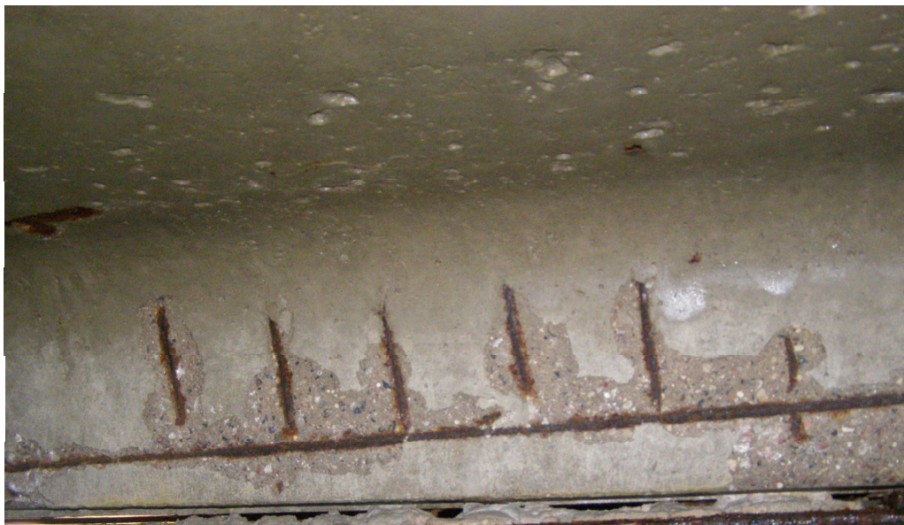
2.7 pav. Denginio plokščių skersinės armatūros padėties pažeidimai
