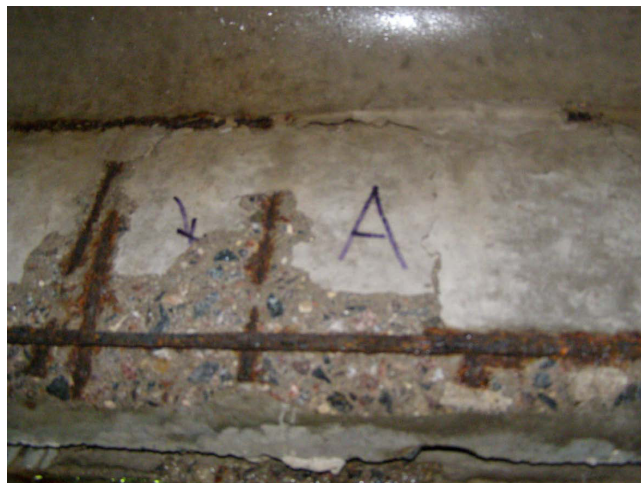
2.10 pav. Skersinė armatūra nukorodavusi
