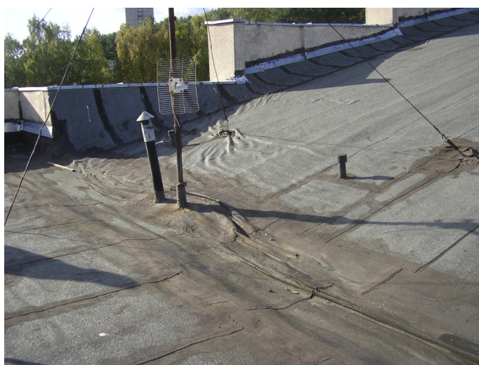
1.4 pav. Stogo dangos pažeidimai
